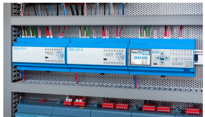
GMA400 mit zwei Relaismodulen GMA200-RT im Schaltschrankaufbau
