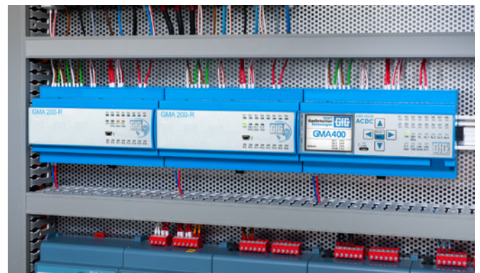
GMA400 mit zwei Relaismodulen GMA200-RT im Schaltschrankaufbau
