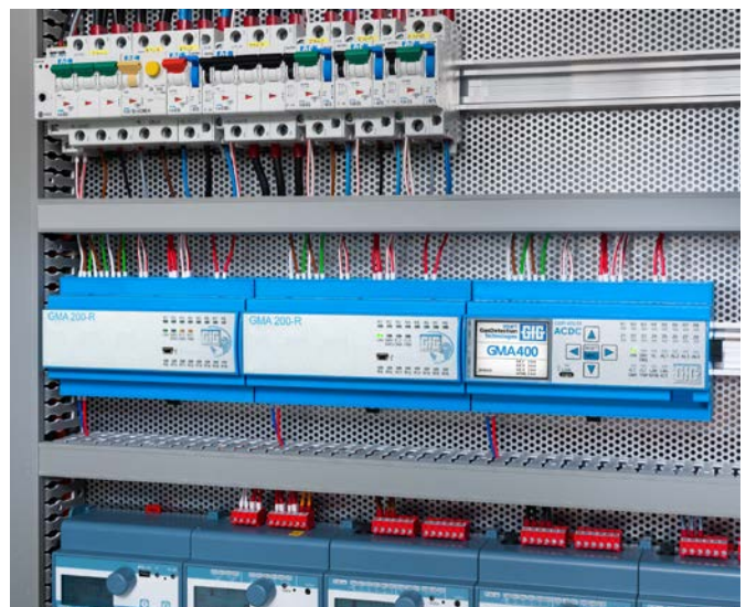
GMA400 avec deux modules relais GMA200-RT dans une armoire électrique
