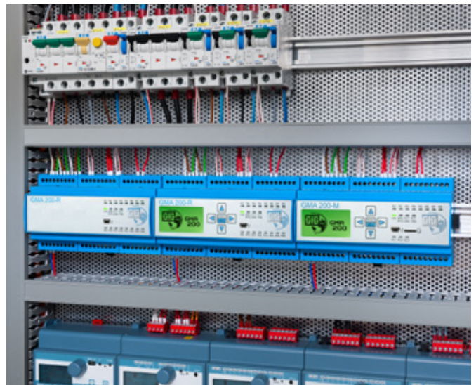
GMA200-MT avec deux modules relais GMA200-RT et GMA200-RTD montés dans une armoire électrique.
